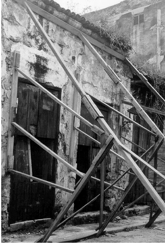
Edificaciones en estado de emergencia
